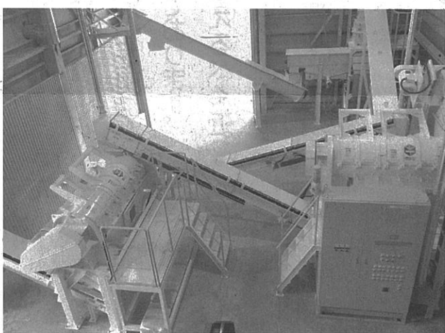
日量80tの処理能力を持つ破砕設備
